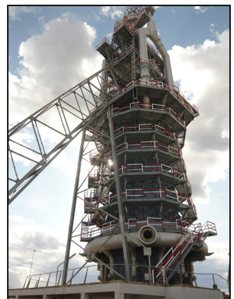
Horno Alto (Ascensor pendiente de instalar)
